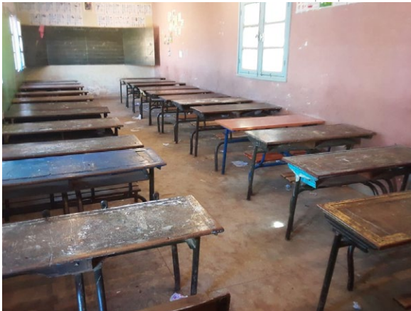
-L'état d'une salle de classe dans l'une des écoles visitées à la périphérie de Casablanca.
