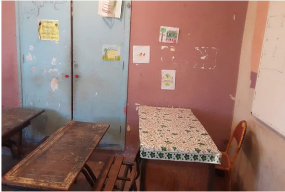
-L'état d'une salle de classe dans l'une des écoles visitées à la périphérie de Casablanca.
